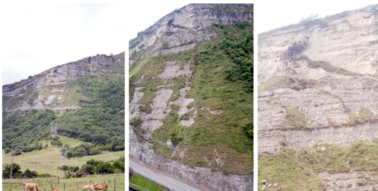
Figura 6. Situación del punto de impacto en la cornisa
