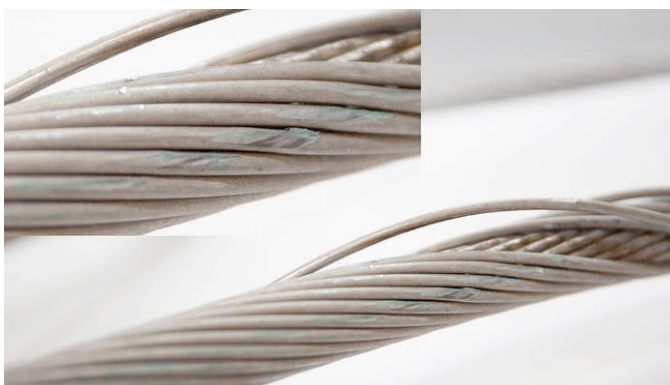
Figura 6. Marcas de pintura verde en cable
