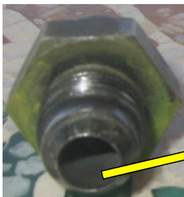
Figura 2. Conector parcialmente obstruido
