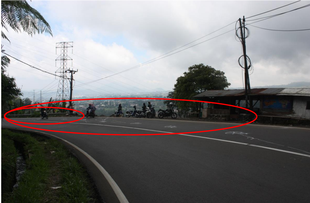
Gambar 38. Kondisi guardrail di tikungan tempat kejadian kecelakaan
