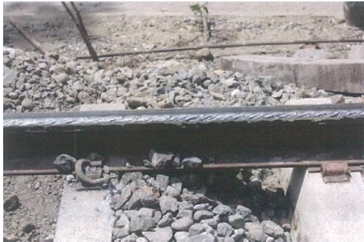
Gambar 3. Jalan rel yang rusak tergerus gear KA 213
