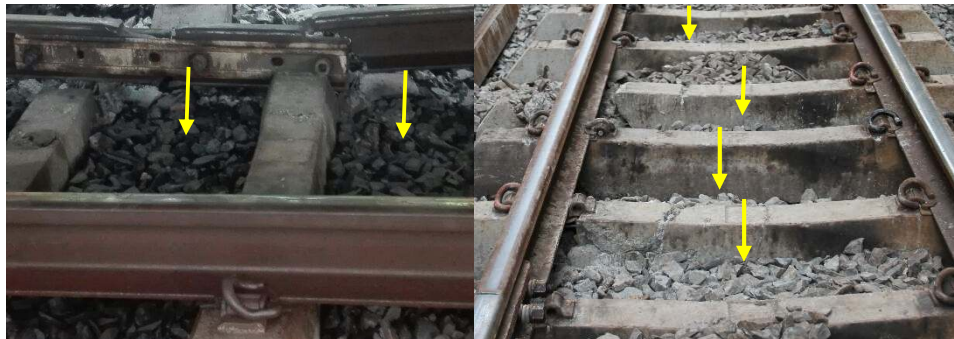
Gambar 5. Kondisi ballast kurang di tempat kejadian
