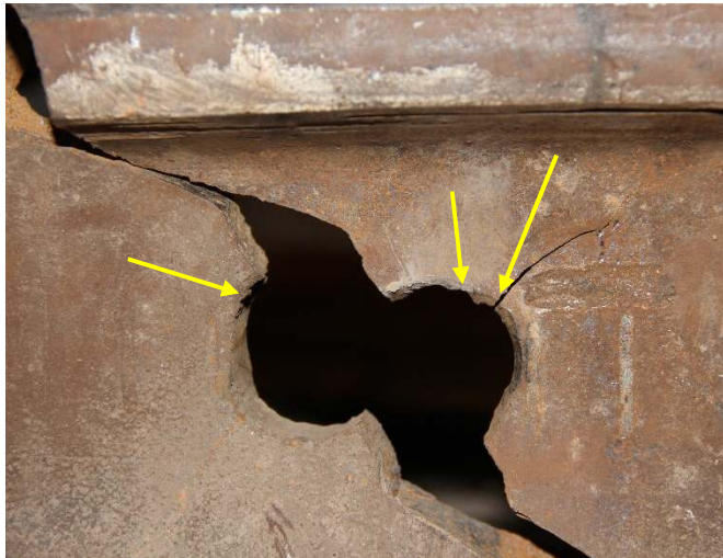
Gambar 4. Takikan / notch pada lubang akibat pengerjaan menggunakan brander
