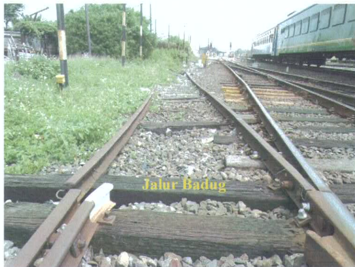
Gambar 7. Jalur badug yang sudah rusak dan tidak terawat
