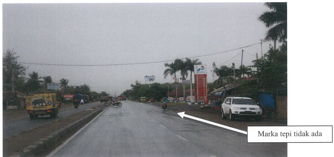
Gambar 1. Marka tepi jalan tidak ada dan tidak ada penerangan jalan umum
