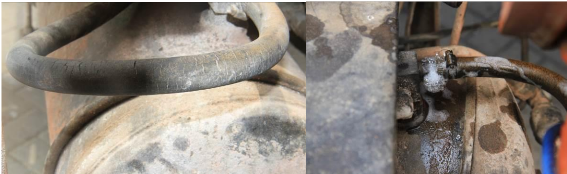
Gambar 2. Kondisi rubber flexible hose valve sudah menua dan mengalami kebocoran.
