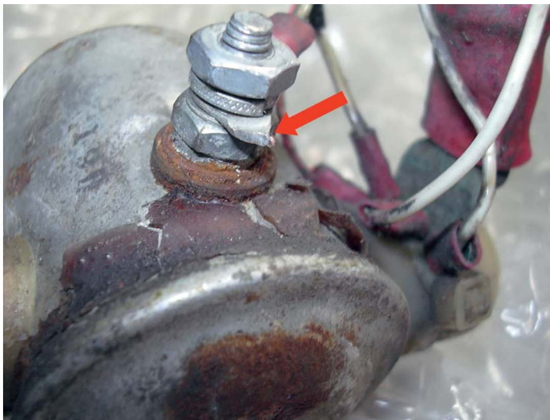
Particolare rottura cavo ancora installato.
