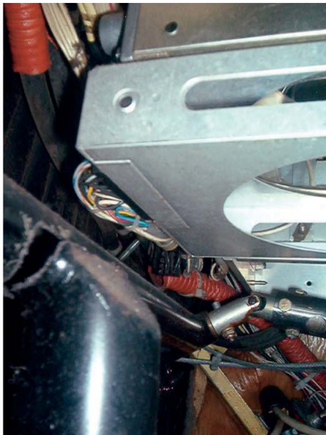
Dettaglio rottura barra a "T".
