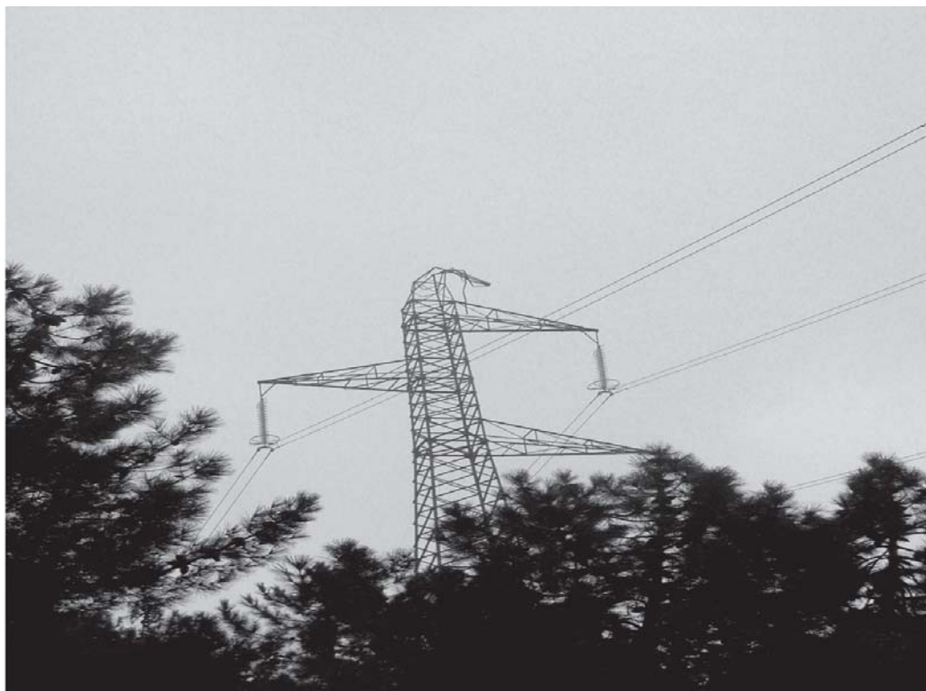
Foto n. 3: il traliccio 42 visto dal basso. Notare il relativo cimino piegato trasversalmente rispetto alla linea elettrica, in direzione del mare.
