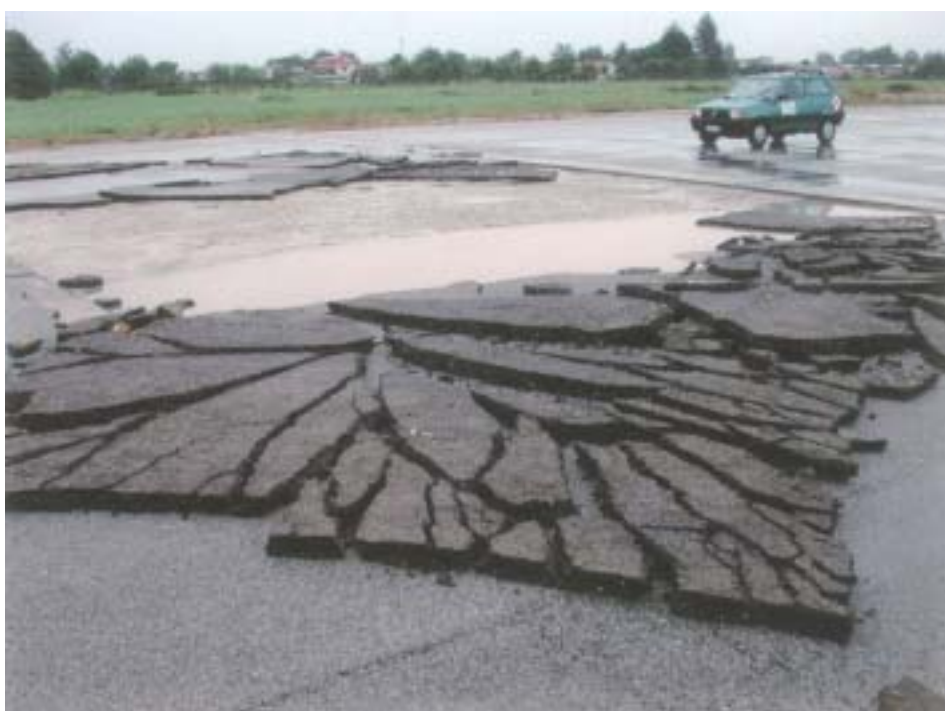
Particolare dei pezzi di asfalto divelti
