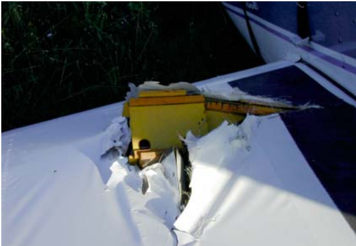
Danni cassone alare SX. Vista dall'alto
