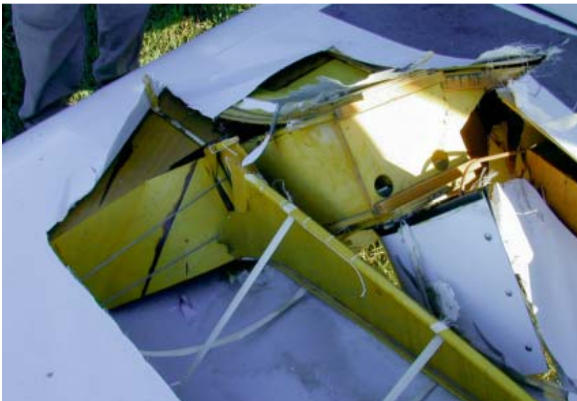
Particolare danni cassone alare dopo rimozione rivestimento
