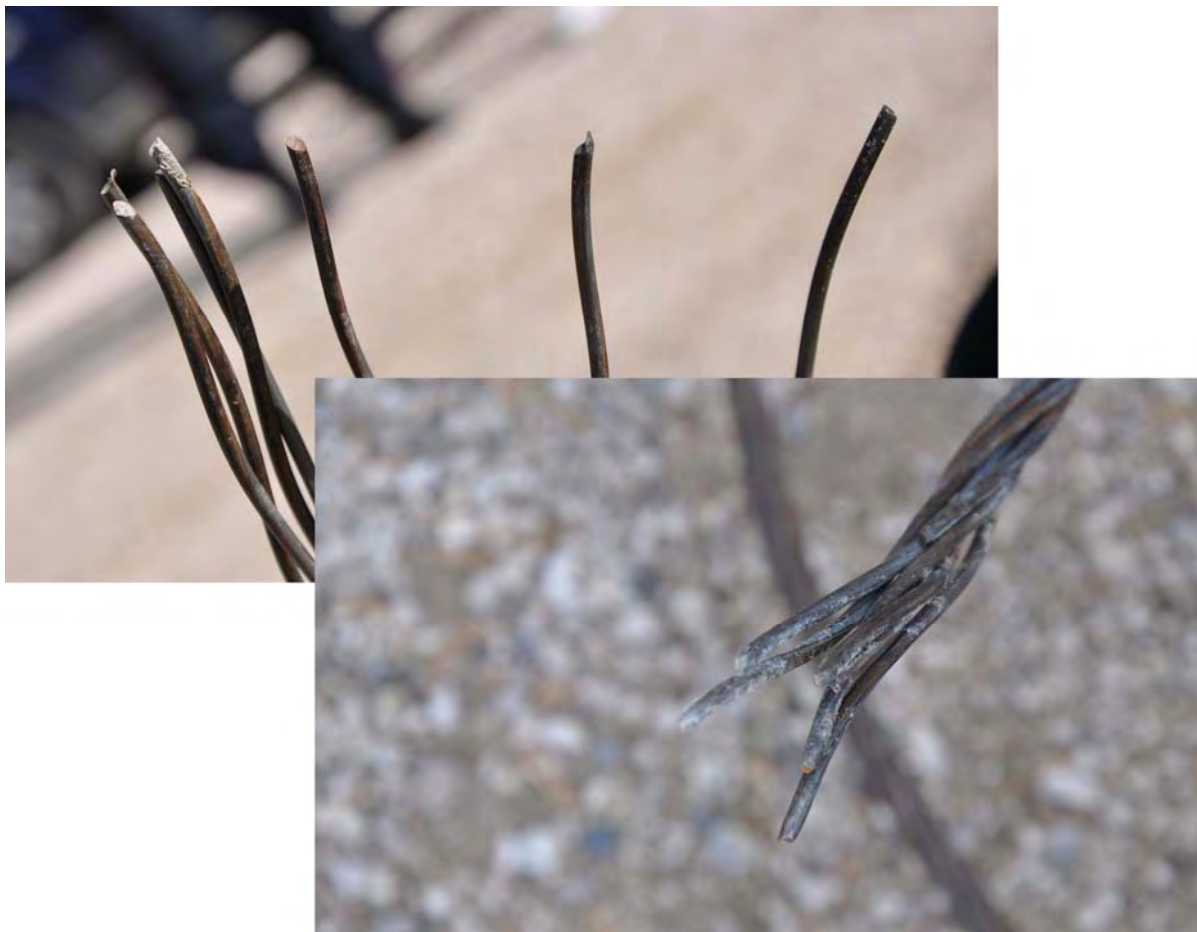
Foto 4: sezioni di rottura cavi linea elettrica.
