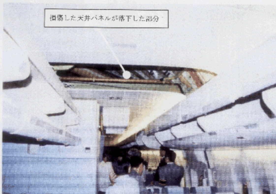
左側通路座席41付近の上部天井パネルの損傷（機体前方から後方を見る）
