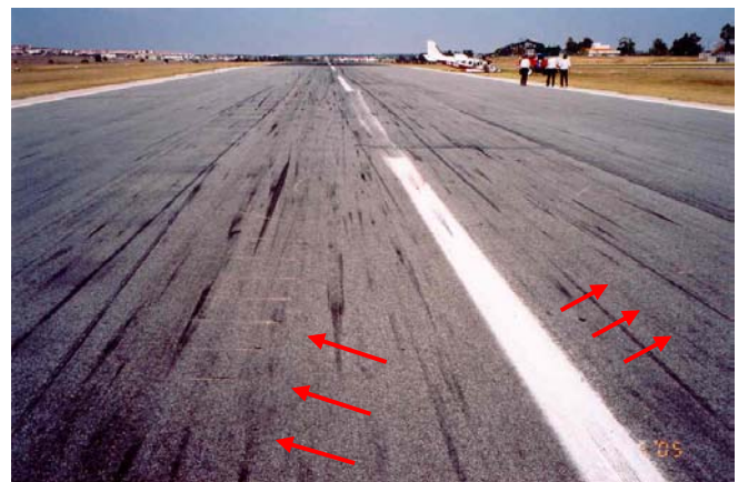
Fig. 8 – Sulcos na pista provocados pelo embate dos hélices no asfalto.
