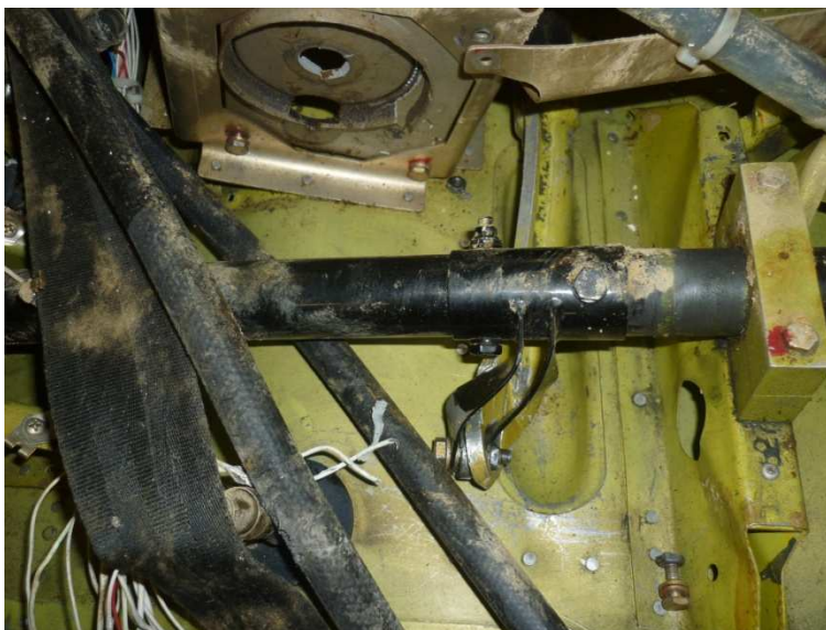
Fig. 13 – Pormenor do estado de deformação da ferragem de fixação do parafuso sem-fim ao tubo de torção de accionamento dos flaps.
