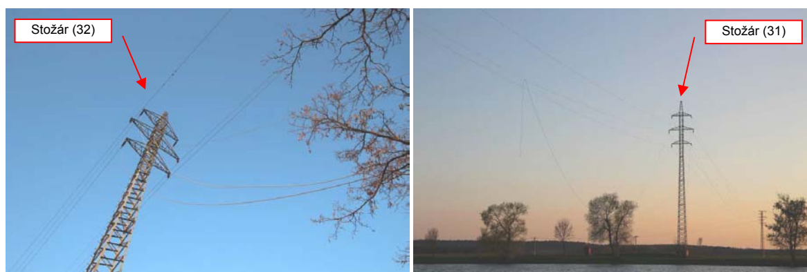
Obrázek č. 2 Přetržené vodiče horního vedení na stožárech na pravém (32) a levém břehu (31).
