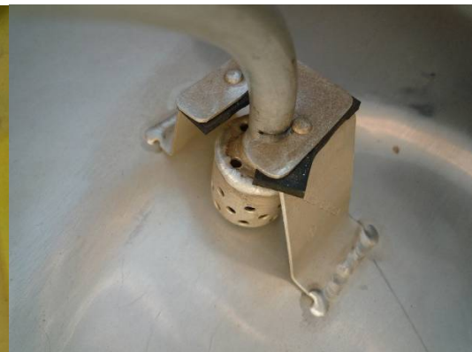
Abbildung 6: Vorgefundene Situation: Saugrohr teilweise verschlossen
